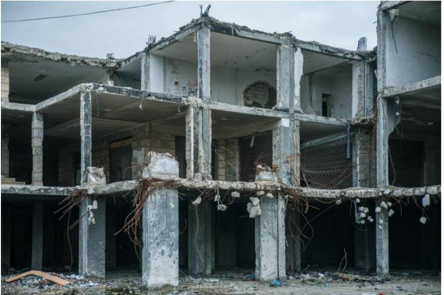
Sud de Gaza - De nombreux immeubles détruits lors du conflit de 2014 n'ont pas encore été reconstruits. © Chloe Sharrock /Circ
